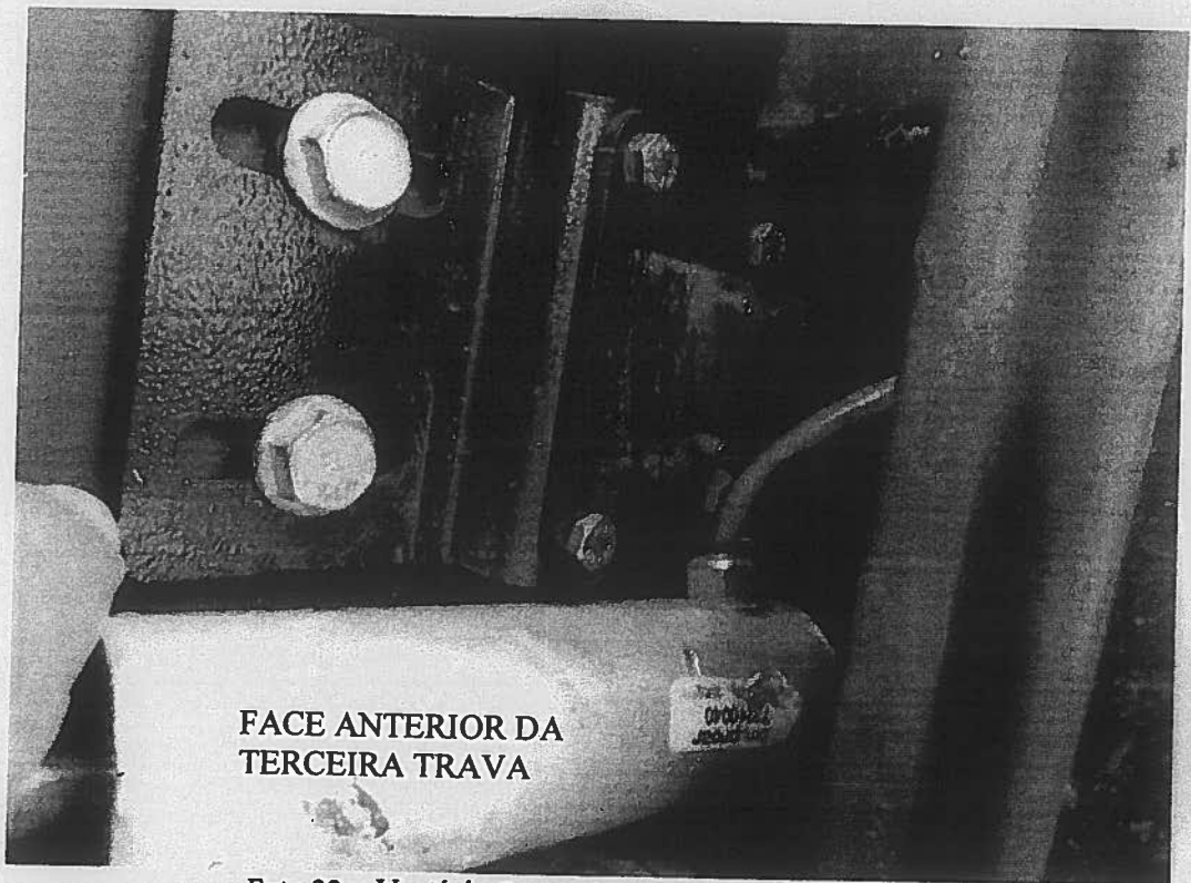
Foto 32 – Vestígio 3: terceira trava desafixada (solta).
