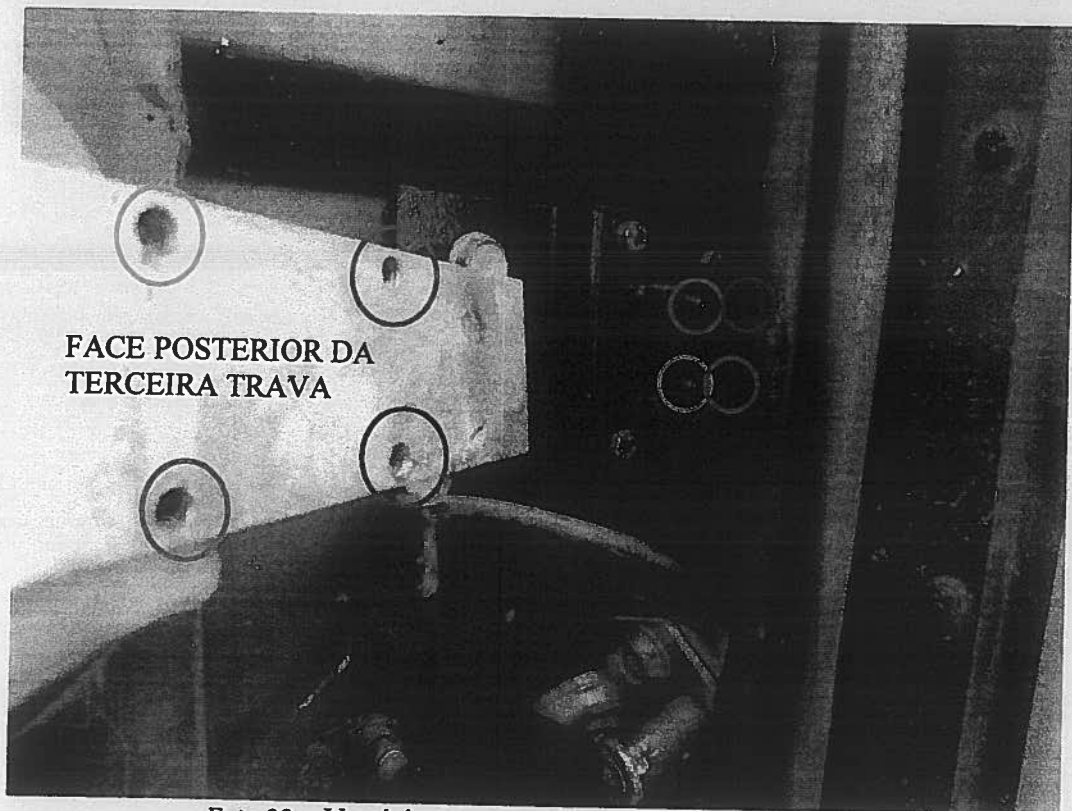
Foto 33 – Vestígio 3: pontos de fixação da terceira trava.
